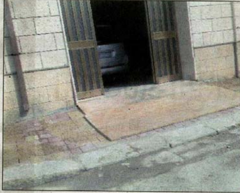
Il marciapiede che costringe un disabile in casa
